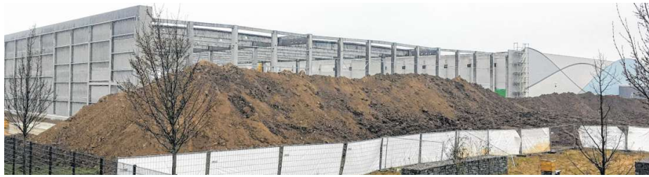
Die neue Halle von Decathlon wächst. Sie wird in südlicher Richtung an das bestehende Logistikzentrum (rechts) angebaut.
